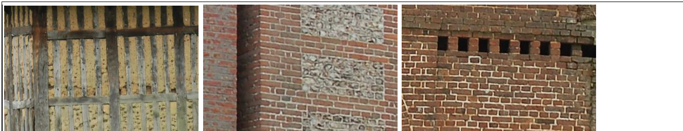
Exemples de matériaux traditionnels locaux (colombage et torchis / brique et silex / brique)
